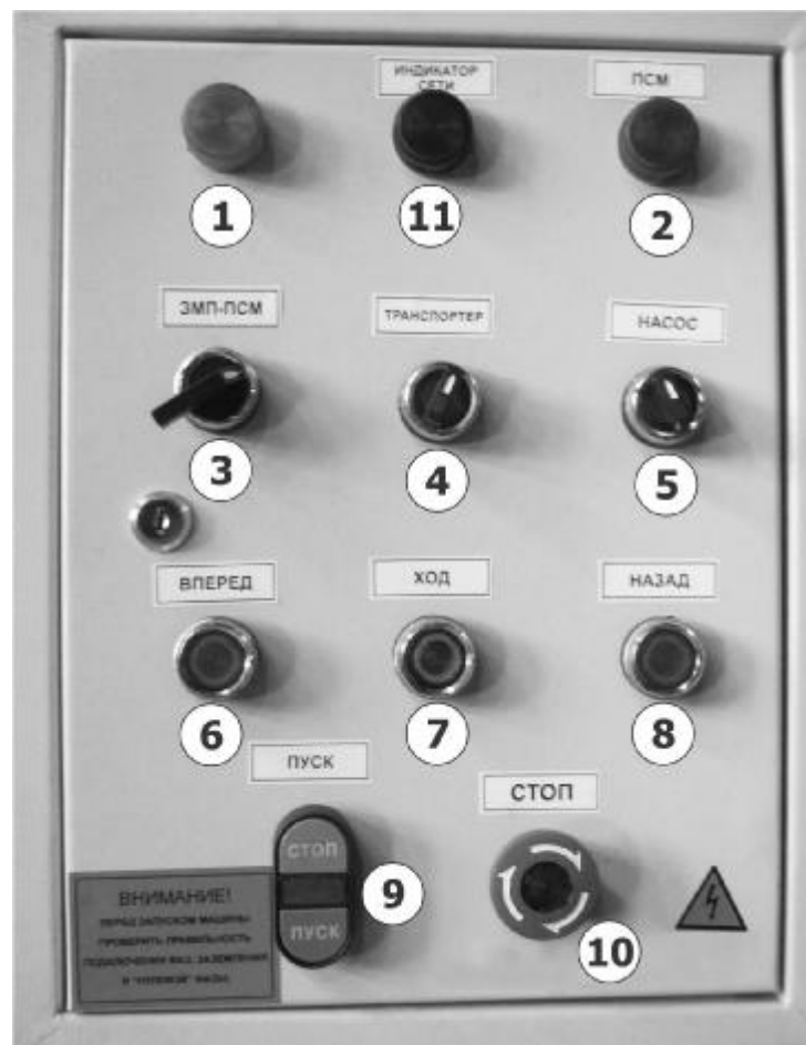
Рис. 12 Ящик электрический (щит управления)
