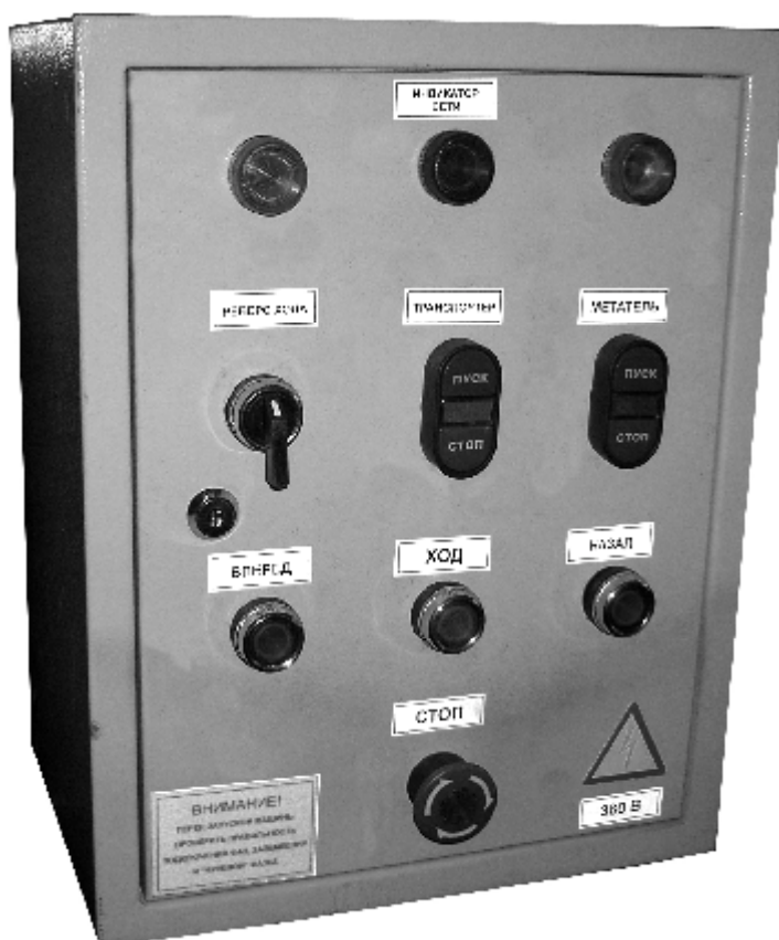
Рисунок 11 Ящик электрический (щит управления)
